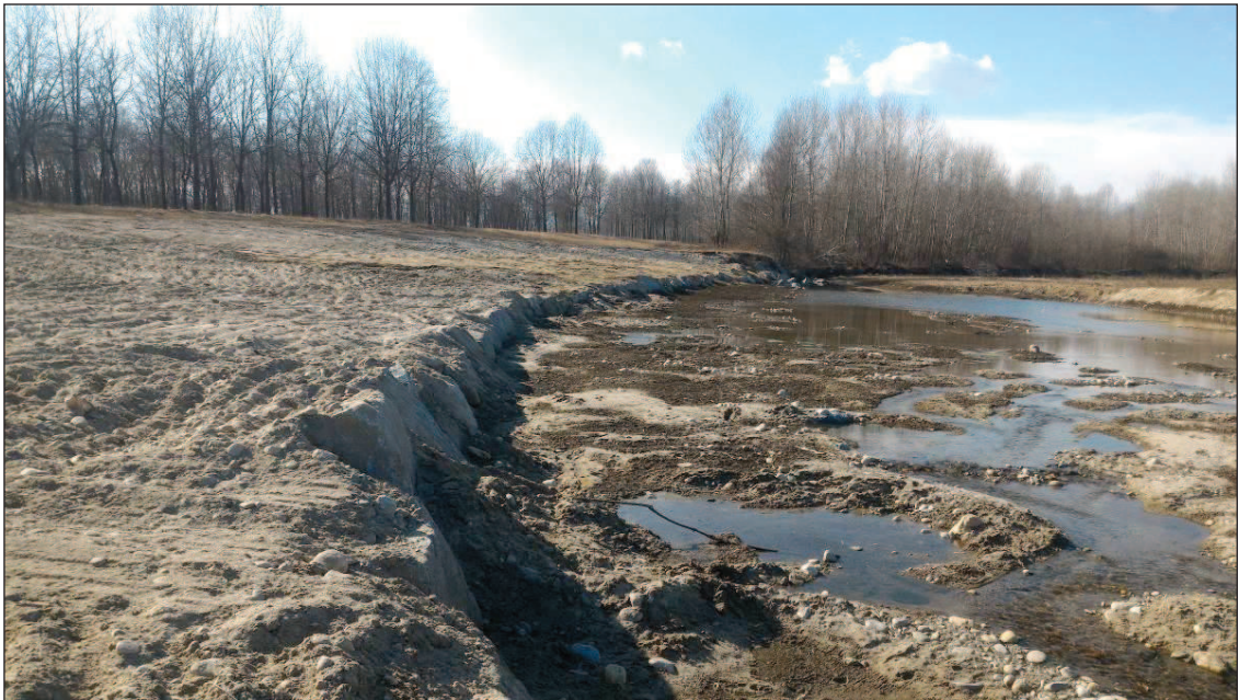
Figura 7.8 – Difesa spondale ripristinata utilizzando i massi della scogliera precedente riportando a tergo materiale prelevato dall'alveo.
